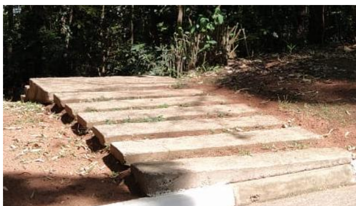
Figura 17. Lateral da escadaria antes
